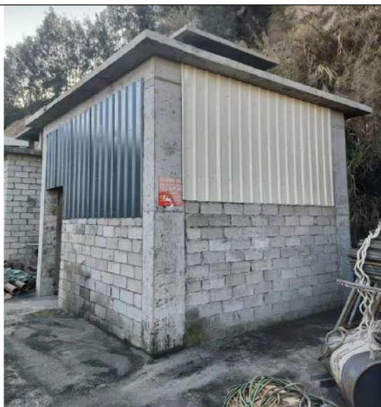
空压机房隔声、减震
