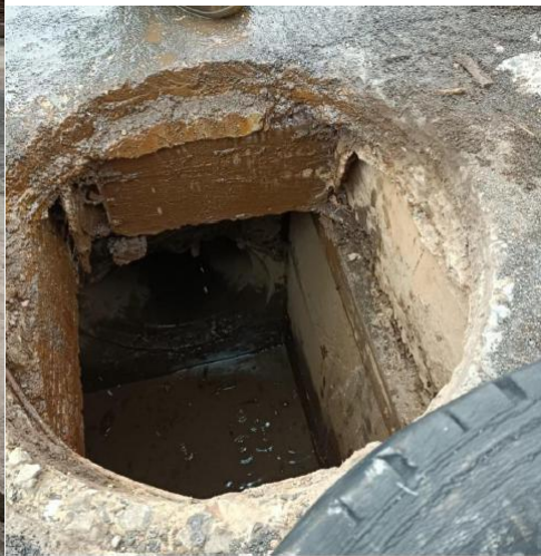
雨水预沉淀池
