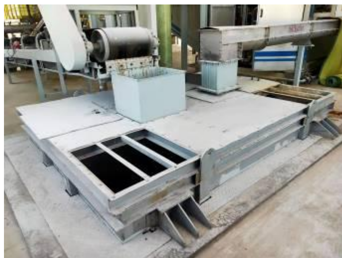
图 8.5-2 现有申远二期项目污泥压滤系统干污泥泥斗
