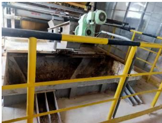
图 8.5-1 现有申远一期项目污泥压滤系统干污泥泥斗
