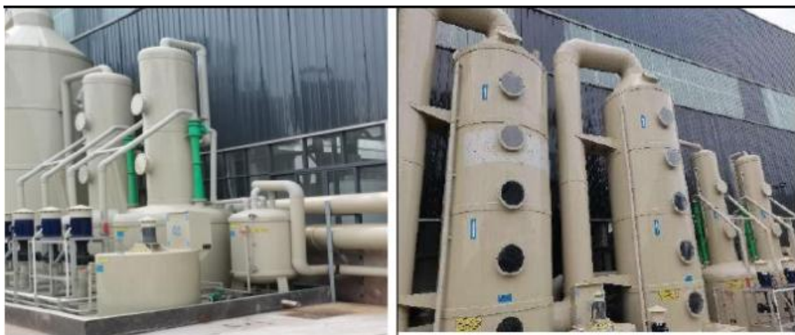
图 7.2-6 真空四级碱液喷射塔和两级碱吸收装置实例照片
