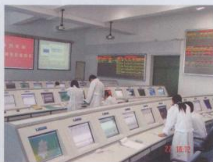
先进的网络监控机房。
